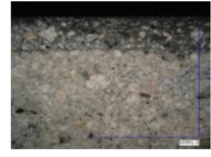
写真4 モルタル押さえの塗装断層
