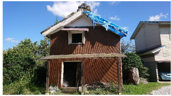
Fig.6 台風で損壊した石井牧士家の蔵
