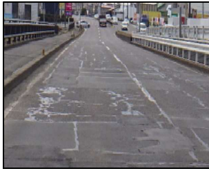
(1) 舗装面の損傷
