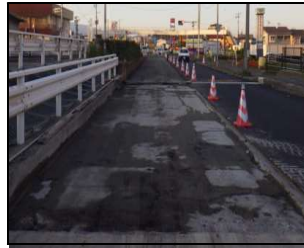
(2) 調整コンクリートの損傷
