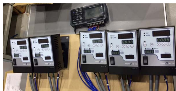
図7 セラミックヒーターおよび温度調整器の設置状況
