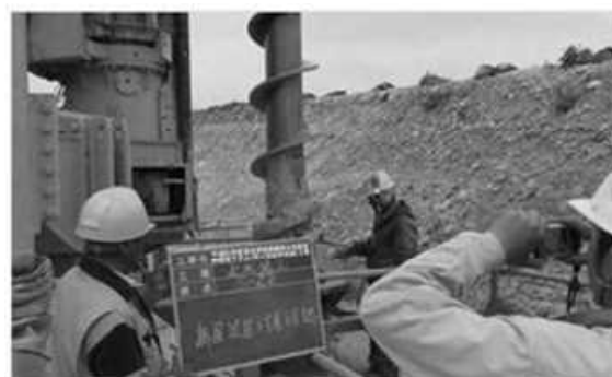
写真1 基盤層土塊の付着確認
