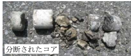
図-1 RC床版内部損傷状況と採取コア例
