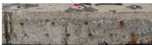
写真-2 試験体のひび割れ状況
