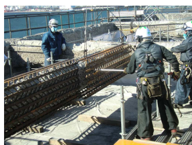
写真-4 設置状況
