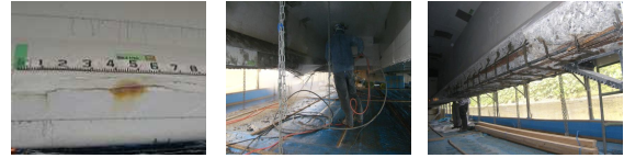
(1) 水平ひび割れ (2) 脆弱部除去 (3) 鉄筋の破断 写真-1 PC 橋の損傷事例
