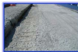
(1)スケーリング
