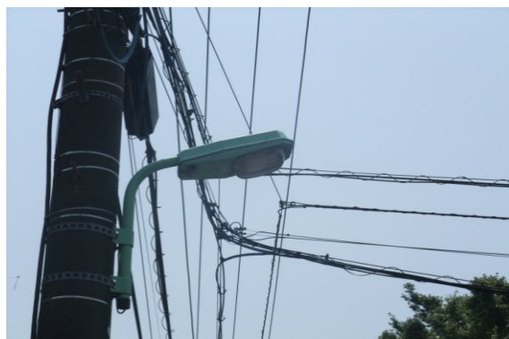
図5 電柱に取り付けられた灯具例
