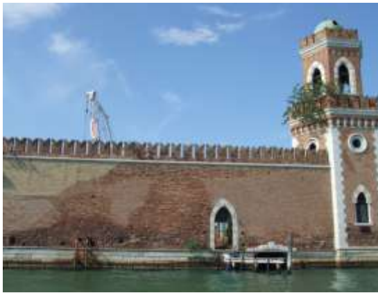
写真-3 レンガの塩類風化（全景）
