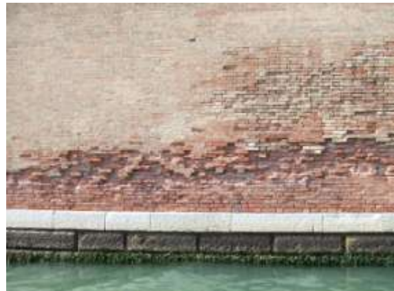
写真-4 レンガの塩類風化（劣化部拡大）
