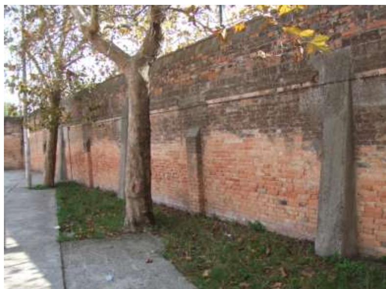
写真-7 教会擁壁レンガの塩類風化
