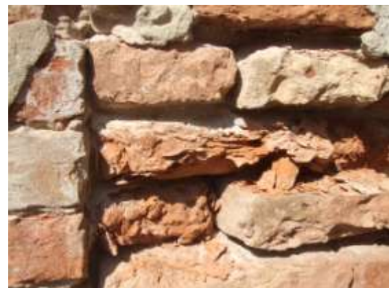
写真-6 塩類風化で破壊されたレンガ
