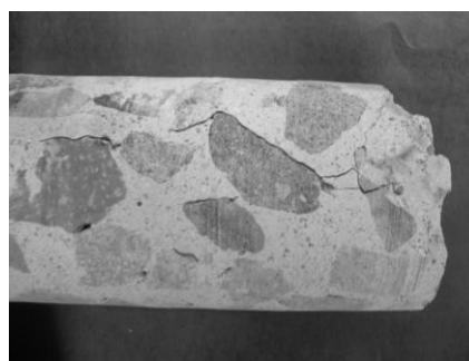
写真-7 圧縮試験後のコア(PQM)
