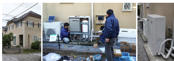
写真1 調査住宅とハイブリッド給湯機
