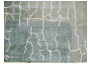
写真 2 床版下面のひび割れ
