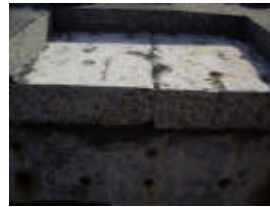
写真 1 付着界面の剥離
