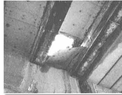
図1 下面鋼板接着による床版抜け落ちの例 1)
