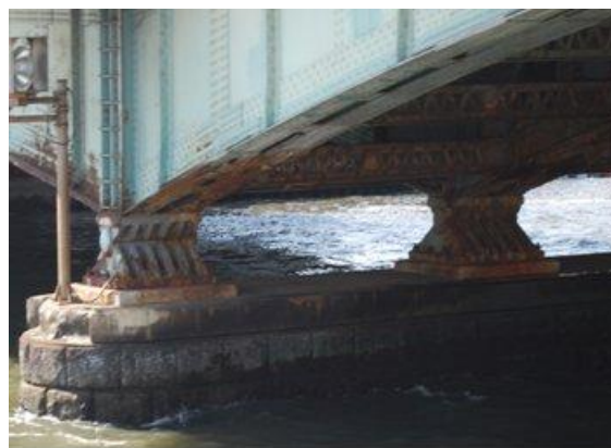
写真 2 両国橋の沓周りの状況 (2009 年 10 月 9 日撮影)
