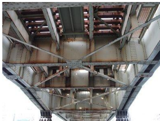
写真 1 総武線隅田川橋梁の床桁と下横構 (2009 年 10 月 9 日撮影)
