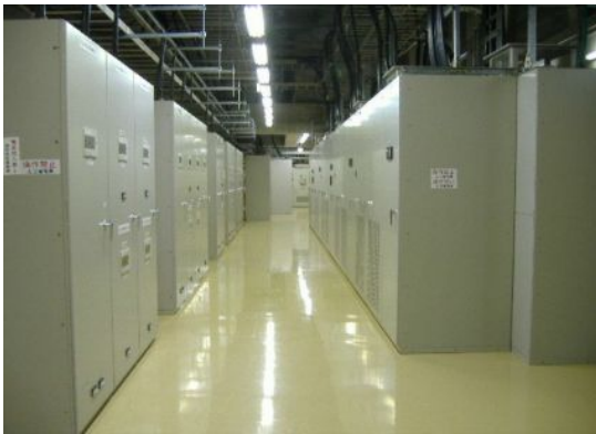
図. 4 JEM規格高圧配電盤（電源室 2）
