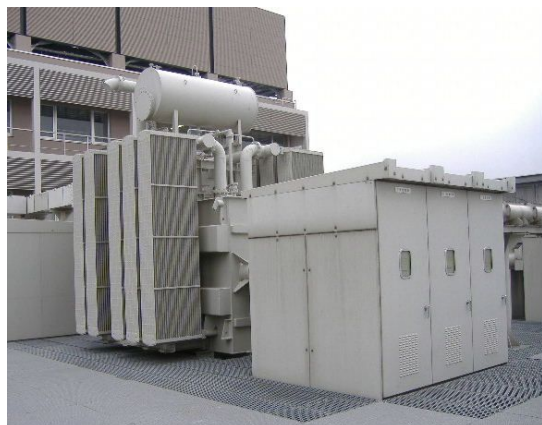
図. 3 66 kV GISと主変圧器
