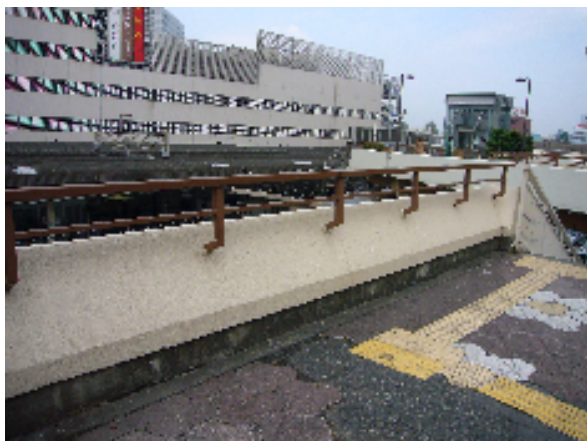
写真-3 柏駅東口ペDESTリアンデッキの壁高欄 (平成 21 年 10 月撮影)
