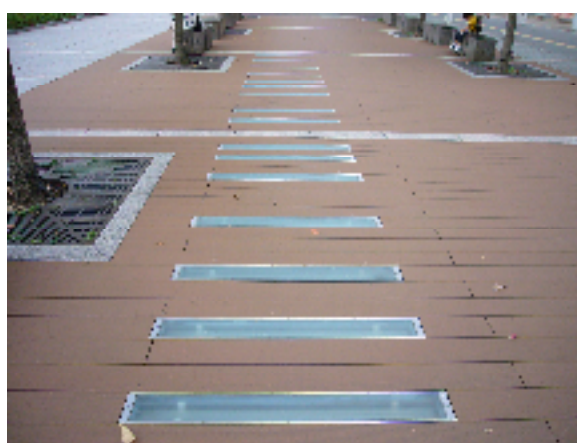
写真-2 さいたま新都心駅東口歩行者デッキの埋設照明 (平成 21 年 10 月撮影)
