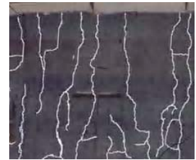
(2) 下面ひび割れ
