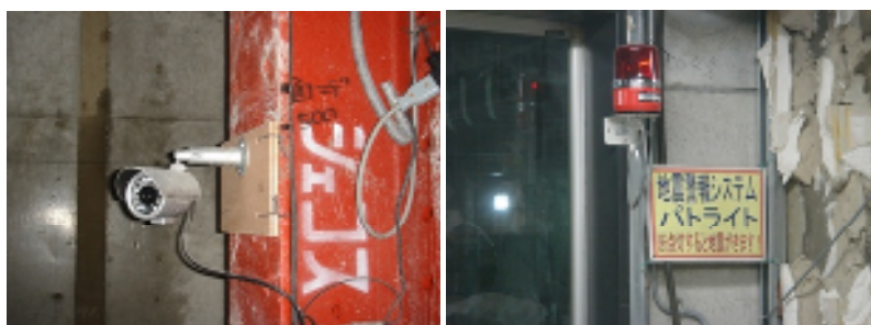
写真3 ジャッキ監視カメラ
