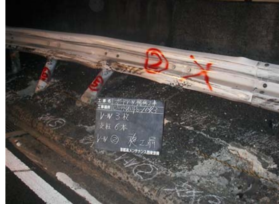
Fig. 1 交通事故によるガードレールの破損状況
