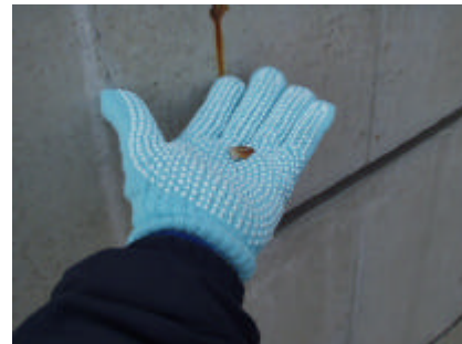
写真2 錆汁起点のポップアウトの状況
