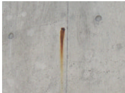
写真1 コンクリート表面の錆汁の事例
