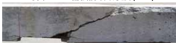
写真 2 補強前破壊状況( 2)
