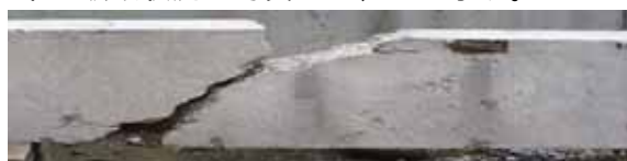
写真 1 補強前破壊状況( 1)
