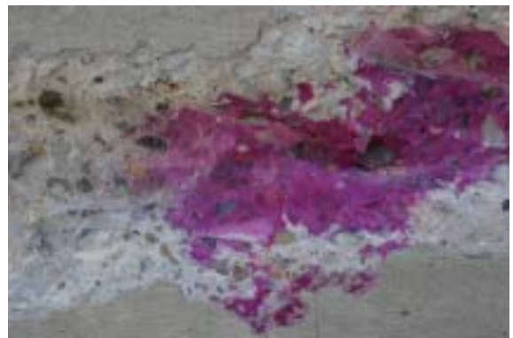
写真-3 コンクリート表面層は中性化せずその下の層が中性化している現象
