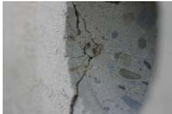
写真-2 鉄筋の腐食・膨張とコンクリートのひび割れ
