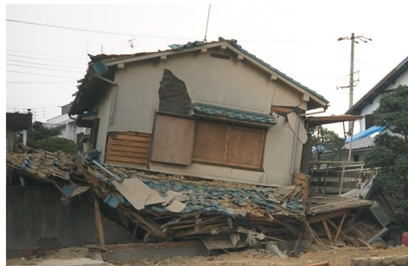
1階部分が層破壊した住宅
