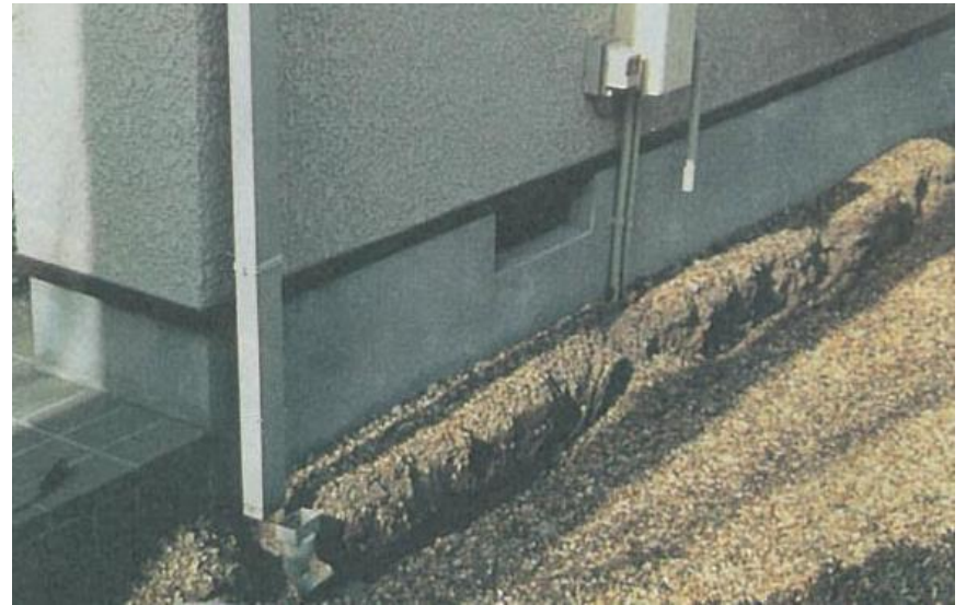
基礎が液状化 (神戸市提供)
