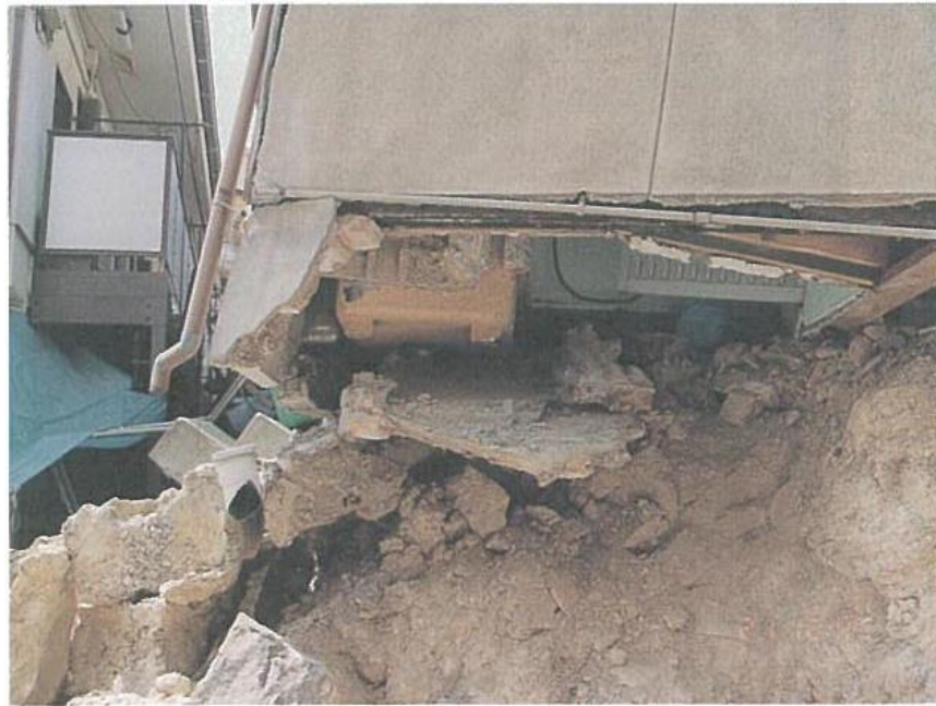
基礎が崩壊している (神戸市提供)
