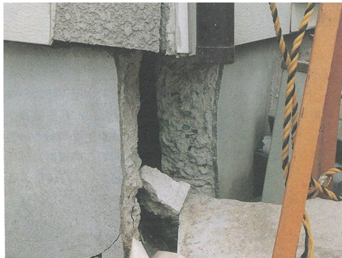
布基礎に鉄筋が入っていない (神戸市提供)
