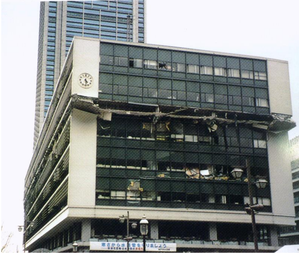
▼6階部分が崩れ落ちた神戸市役所2号館。
