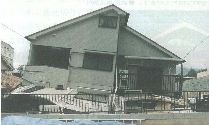
図5-25 1階部分が崩壊した新築住宅。 1階の壁量が不足していると考えられる (神戸市提供)
