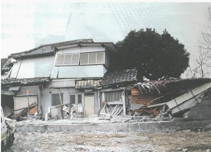
図5-26 2階の無理な増築による崩壊(神戸市提供)
