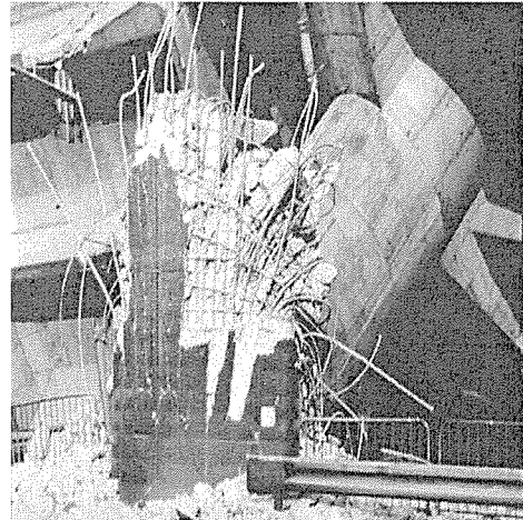
図-1 RC 橋脚の破壊状況 2)
