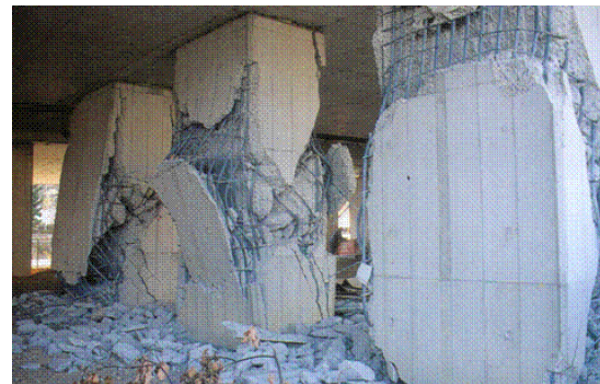
図-1 RC 柱主鉄筋の座屈 1)
