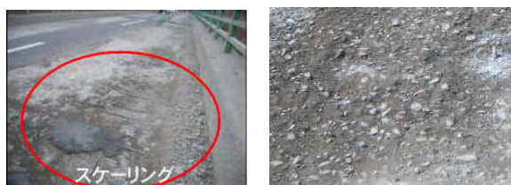
1)凍害による鉄筋の露出 3) 2)凍害による砂利化 写真-1 塩害・凍害劣化したRC床版の損傷状況
