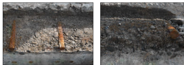
(3) 塩害による鉄筋の錆
