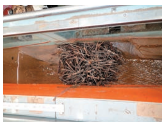
図1 天然ダム侵食路での流木集積状況
