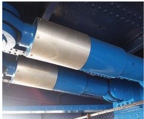
写真3 ダンパー（清洲橋）
