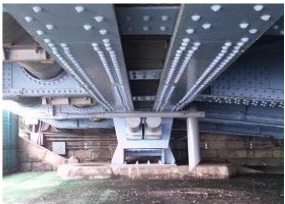
写真7 橋台部落橋防止システム（永代橋）
