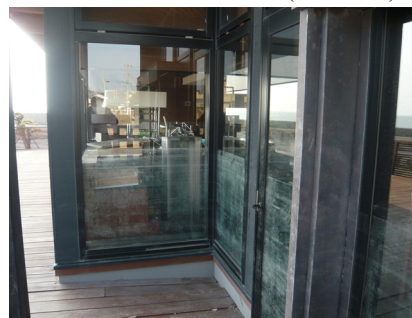
写真-2 家屋における浸水跡(調査点 5)
