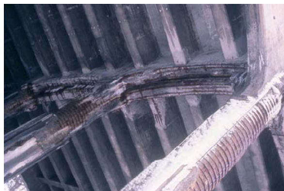
写真2 橋梁下面の塩害による損傷（米国）
