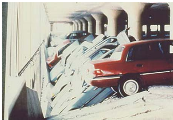
写真3 駐車場の塩害による崩落（米国）
