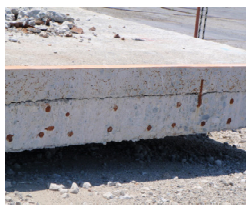
写真-1 付着界面の剥離
