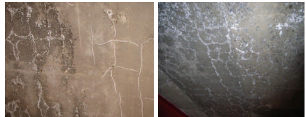
(1) 疲労損傷 (2) 塩害・凍害による劣化 写真-1 道路橋RC床版の破損状況の一例
