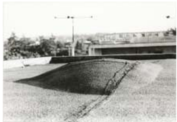
写真-1 防水層のふくれ
