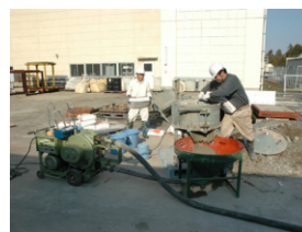
写真 1 ミキサ、ポンプの外観状況
