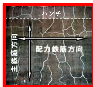
図-2 鋼合成桁橋RC床版の損傷状況
