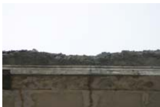
Photo 4 凍結融解による底の劣化
