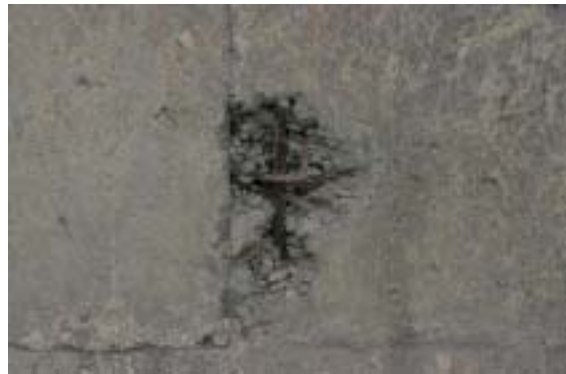
Photo 5 ジャンカおよびかぶり不足による鉄筋の腐食、コンクリートの仕上がり状態の悪さ
